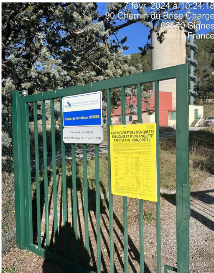
Poste de livraison Signes
